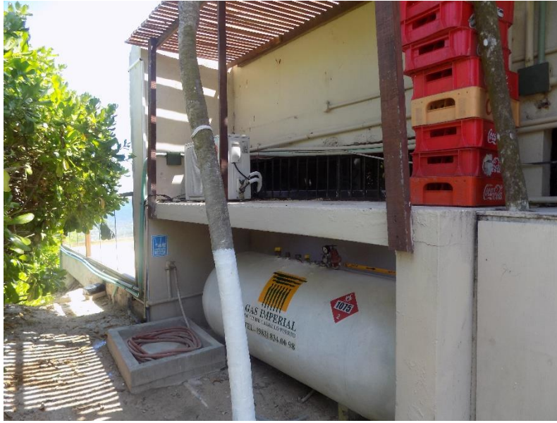
Figura VIII. 8 Área de tanque de gas LP
