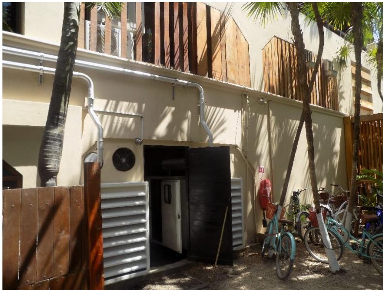
Figura VIII. 7 Cuarto de generadores de energía
