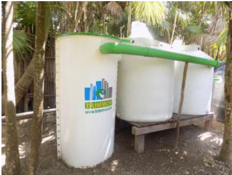
Figura VIII. 8 Sistema de biodigestor (Polígono 2)
