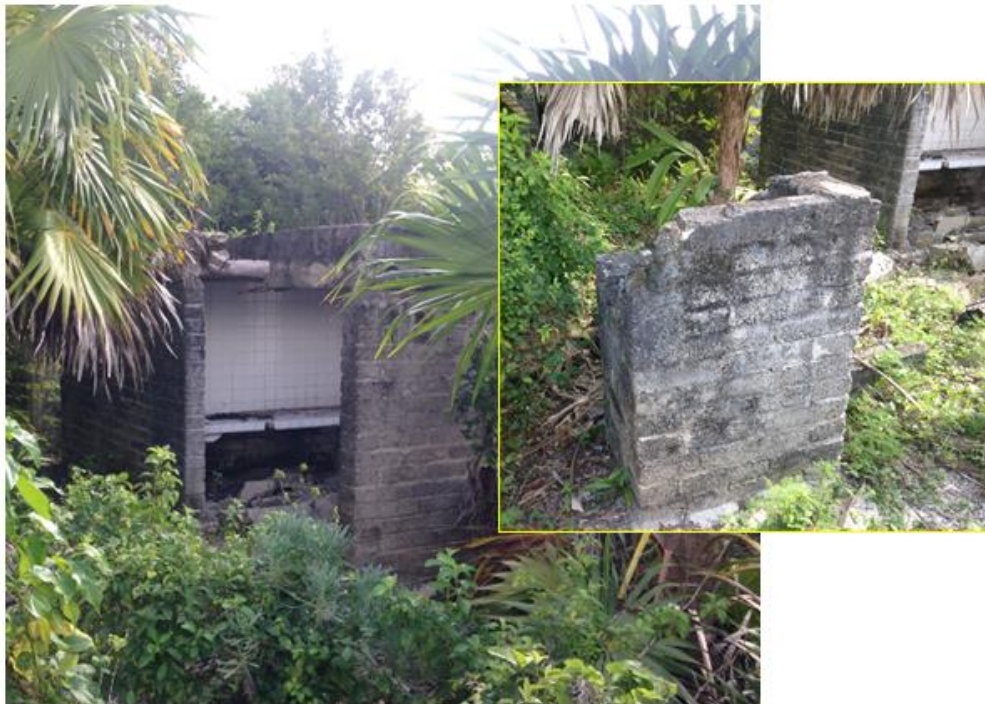
Ruinas de obra civil
