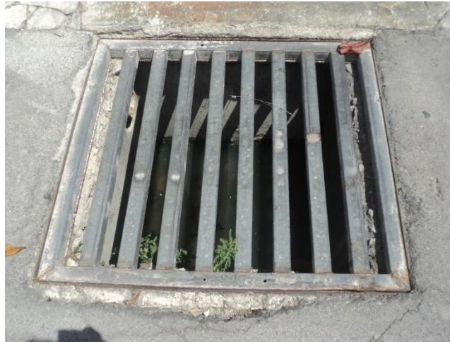
Figura II.8. Rejilla de captación de agua pluvial ubicada frente al predio.
