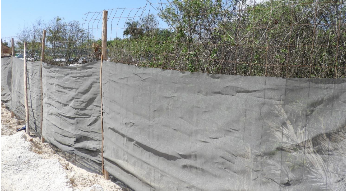
Figura 7 . Malla instalada para la reducción de polvo fuera de las áreas de trabajo.
