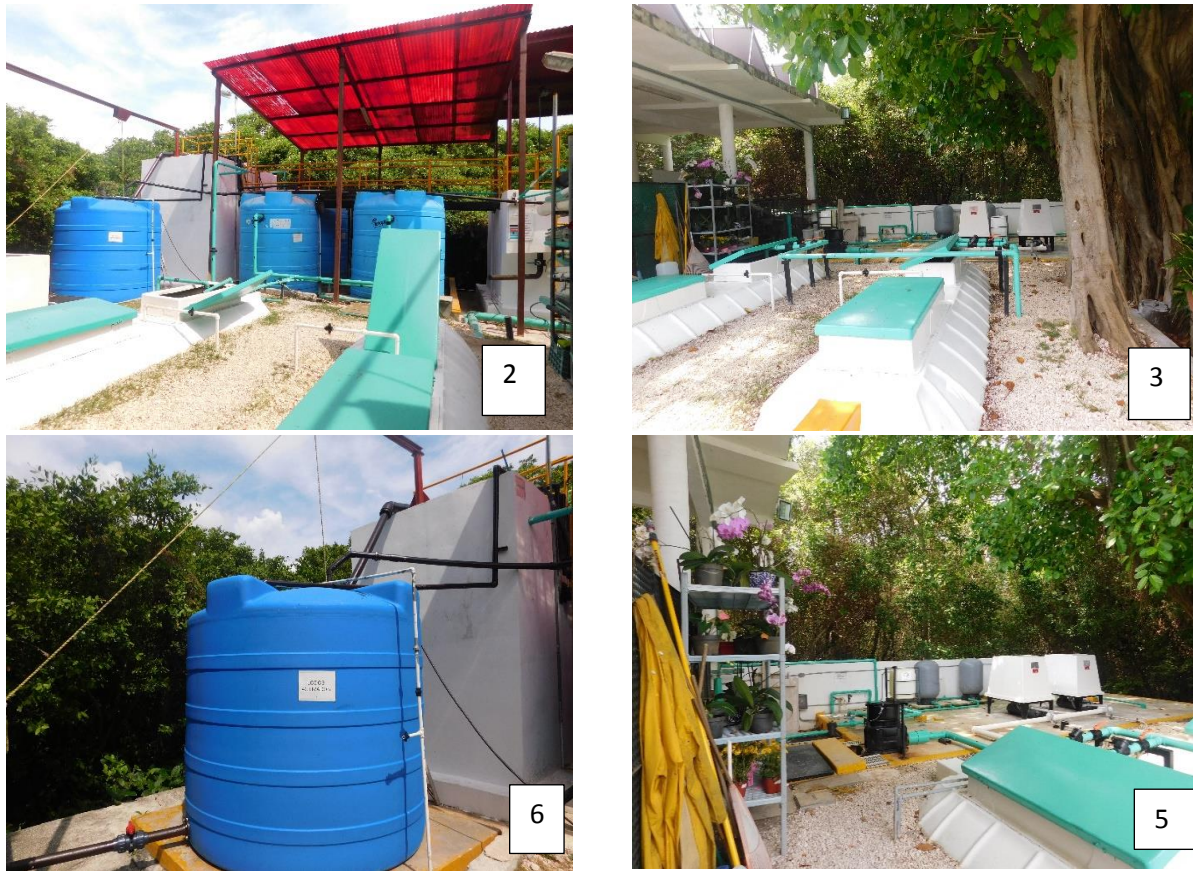
Figura 23. Planta de tratamiento de Aguas Residuales, 2. Tanque regulador y homogenizador, 3. reactor biológico, 6. Tanque Digestor de lodos activados y 5. Desinfección
