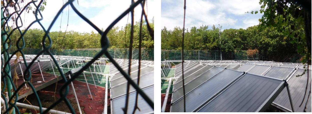
Figura 14. Actualmente en las canchas de tenis se encuentran celdas solares.
