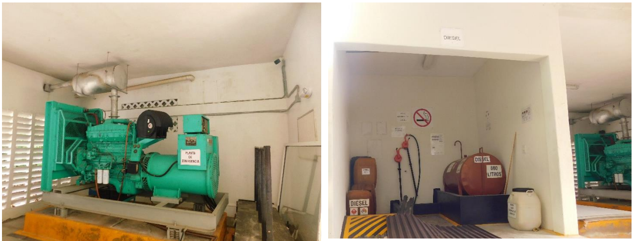
Figura 26. La planta de emergencia tiene un motor diésel, con filtros que reducen las emisiones a la atmosfera, al lado se encuentra el tanque diésel mismo que se encuentra perfectamente delimitado para contener posibles derrames y reducir los riesgos.
