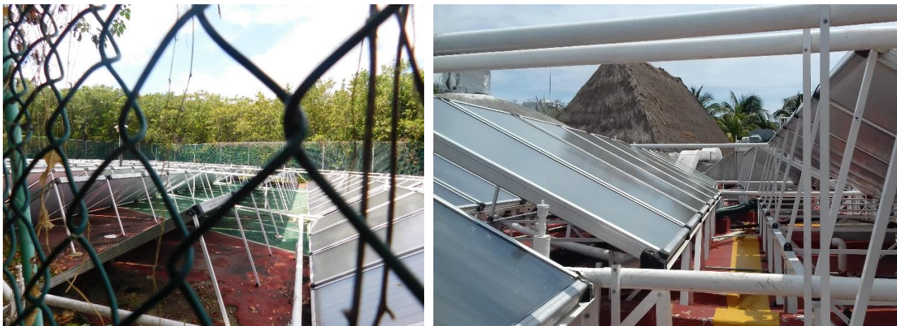
Figura 17. Paneles solares en la cancha de tenis y en la azotea de ama de llaves
