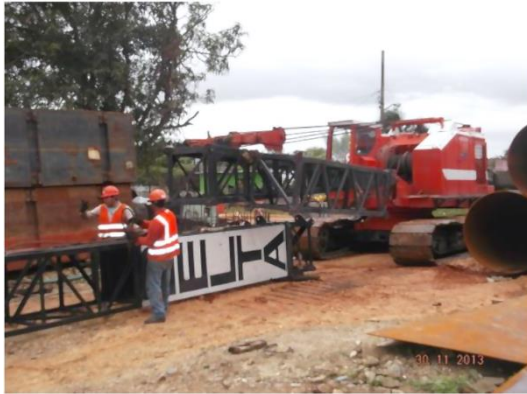
Figura II-11. Instalación de la maquinaria Torre Grúa para la guía e hincado de los elementos constructivos de la pila.
