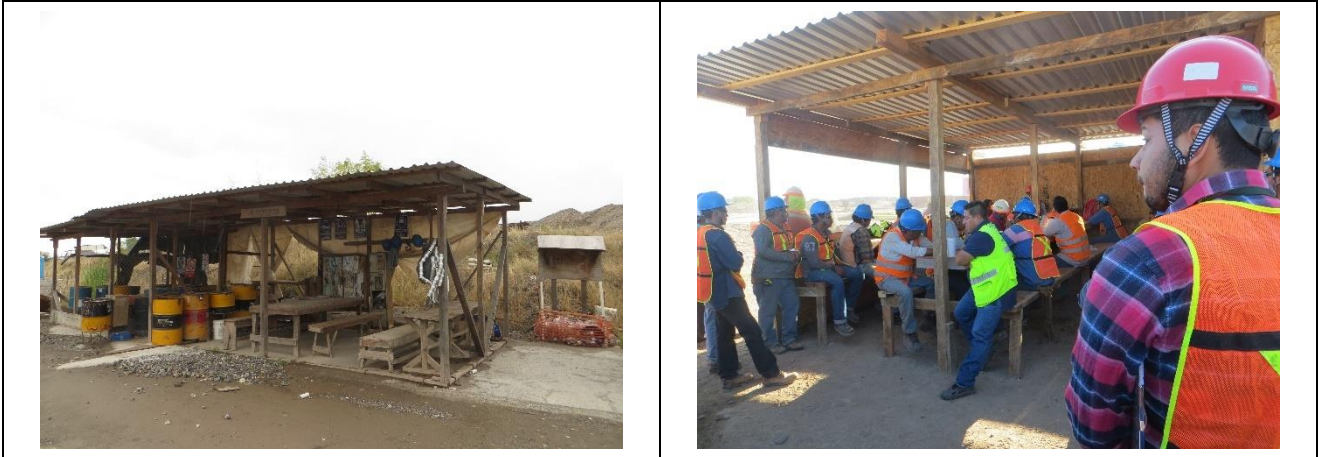
Figura II-8. Ejemplo de la habilitación de áreas para el consumo de alimentos y descanso para los trabajadores de obra durante la etapa de construcción.
