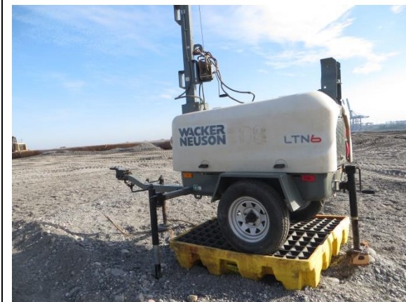
Protección de equipos contra fuga de hidrocarburos
