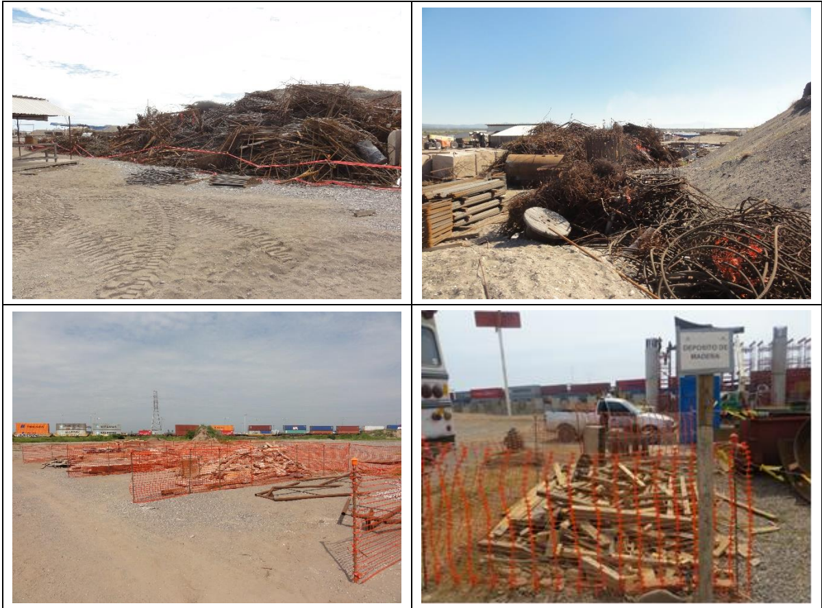
Figura II-15. Ejemplo de la habilitación y señalización de áreas para la disposición temporal de residuos de manejo especial durante la etapa de construcción.
