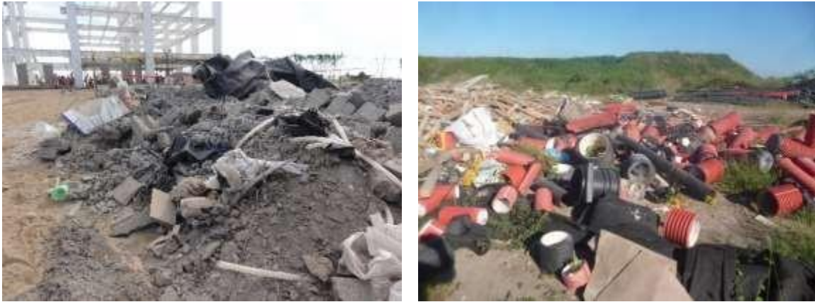
Figura 37 Ejemplo de evidencias del mezclado durante la disposición temporal de residuos de manejo especial durante la etapa de construcción.
