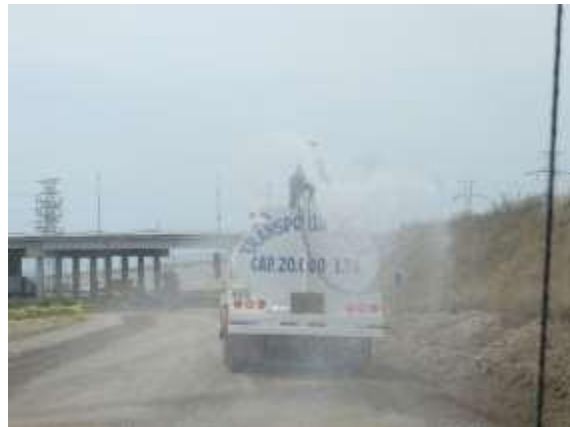
Aplicación de riegos para reducir la suspensión de partículas de polvo en el aire en los frentes de trabajo y circulación vehicular.
