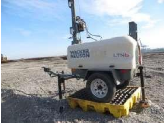
Protección de equipos contra fuga de hidrocarburos
