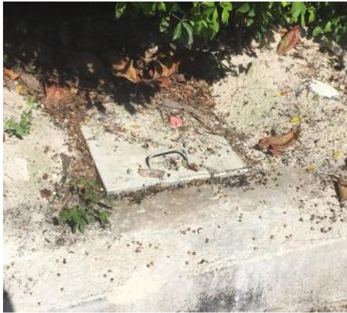
Fotografía de registro de aguas negras del predio para lote 01, previo a la red municipal, sobre el area de banquetta.
