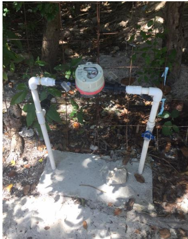
Fotografía de medidor de aguas potable del predio para lote 03, previo al ingreso a la casa por construir.
