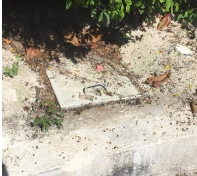
Fotografía de registro de aguas negras del predio para lote 01, previo a la red municipal, sobre el area de banquetta.
