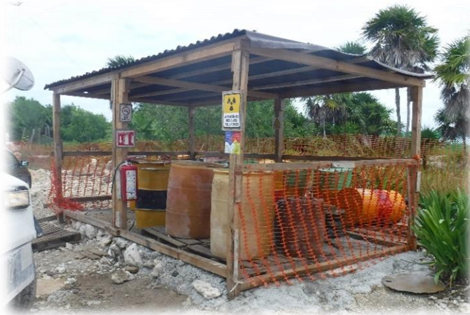
Figura VI:8 Ejemplo de almacén temporal de residuos peligrosos. Fuente: SYLVATICA, S.C. ®.
