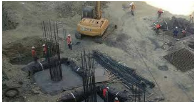
Figura IV-44 Ejemplificación de la medida de mitigación para aislar la construcción de la cimentación con el suelo y el manto freático
