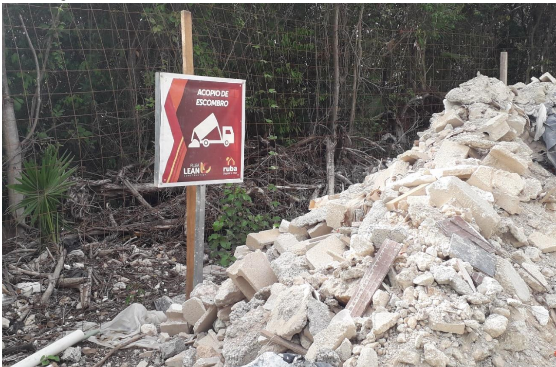
Señalización y delimitación de un sitio de acopio de escombros.
