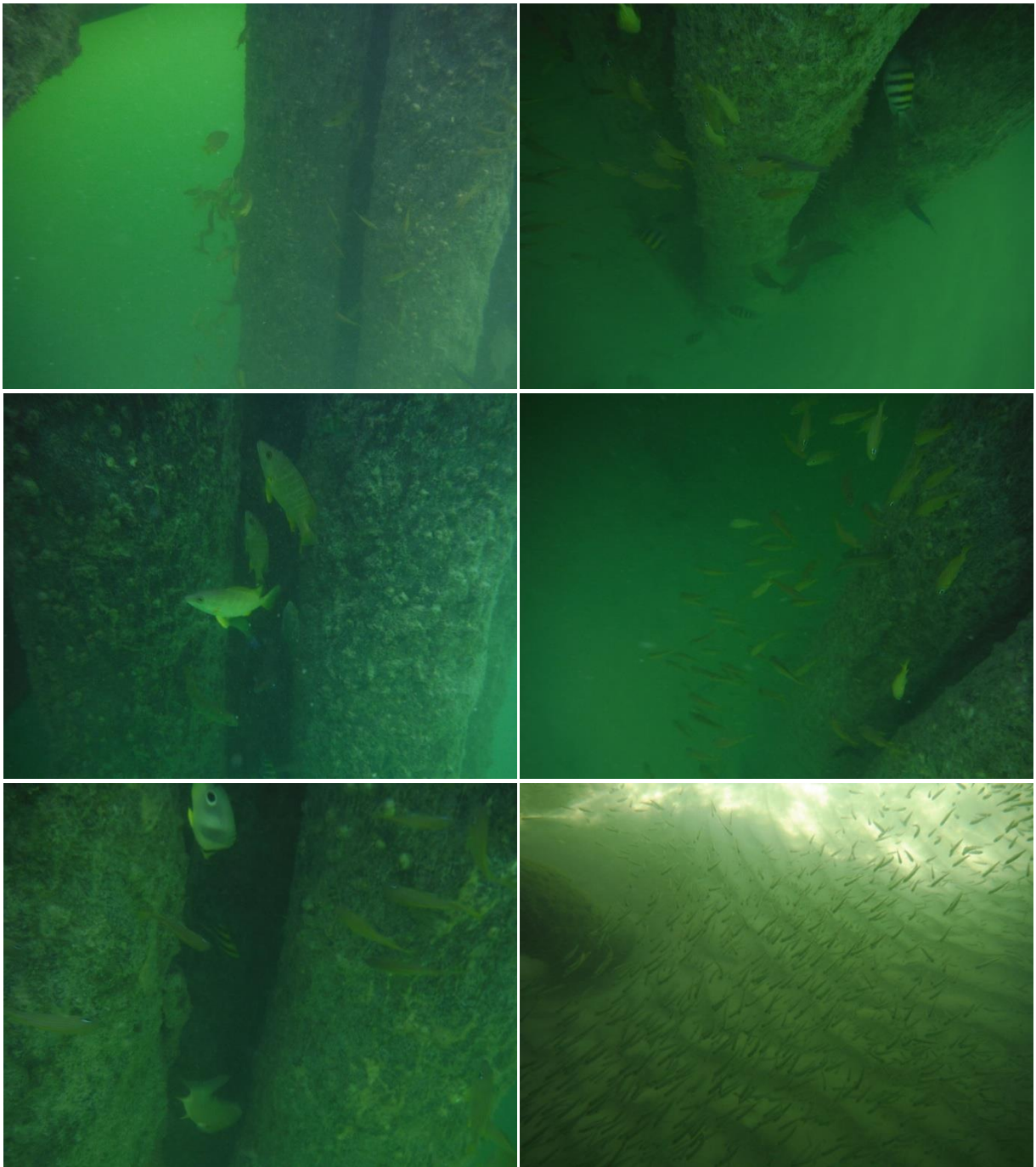
Figura 14. Peces refugiándose debajo de la estructura de un atracadero.
