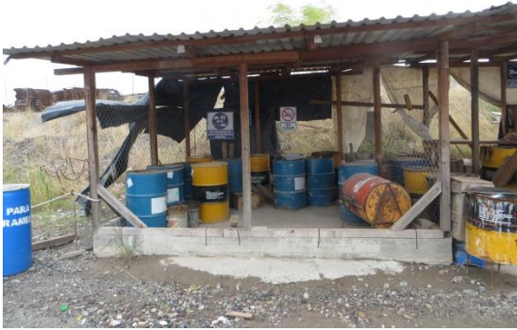
Habilitado de un almacén para la concentración momentánea de residuos peligrosos y sustancias químicas en un frente de trabajo.
