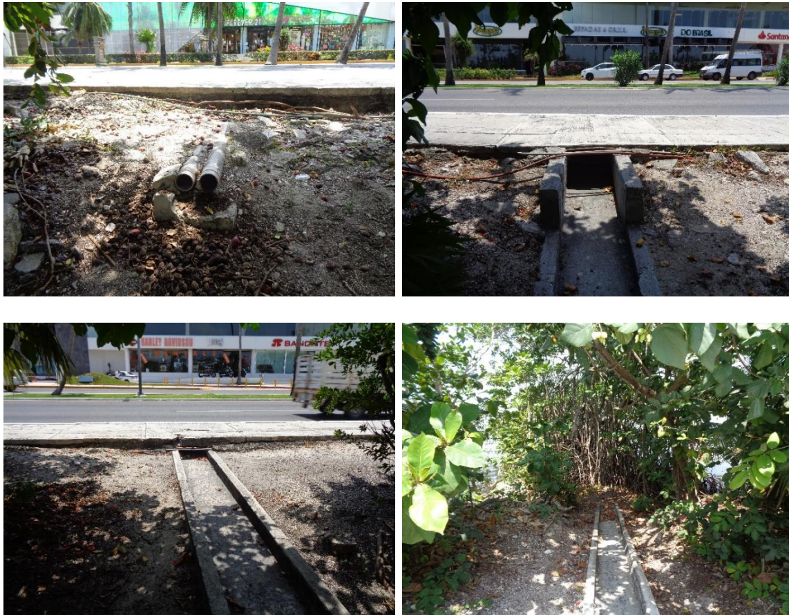
Figura 4.108. Condiciones generales de la zona este puente Nichupté, instalación de tubería y canaletas de concreto como parte del sistema de descarga de aguas pluviales (1/2).
