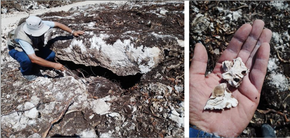
Figura IV.2.1.86. Oquedad notoria en calizas fosilíferas en las obras de acceso al aeropuerto de Tulum.
