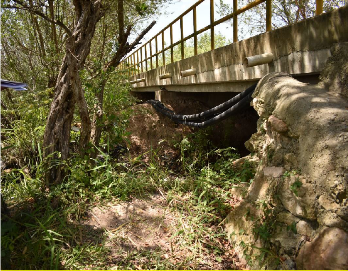
Figura IV.2.1.108. Obstrucción y azolvamiento de la alcantarilla de intercomunicación de un sistema laguna Progreso, Puente de La Sabana, Calle colibrí, Chetumal
