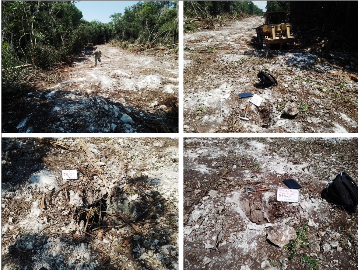
Figura IV.2.1.83. Oquedades halladas en el frente de avance del camino de acceso hacia el Aeropuerto Internacional de Tulum, en pleno proceso de despalme para iniciar su construcción.
