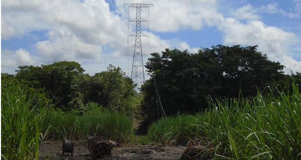
Figura 10. Torre autoportada con poleas colocadas y cable listo para las maniobras de tensado.
