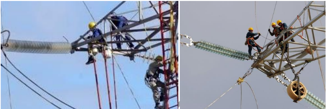
Figura 9. Imagen ilustrativa del vestido de estructuras (Torres).
