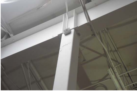
FIGURA 2.112 DETALLE DE COLUMNA CUADRA METÁLICA CON REMATE DE VIGA DE ACERO TIPO "H"
