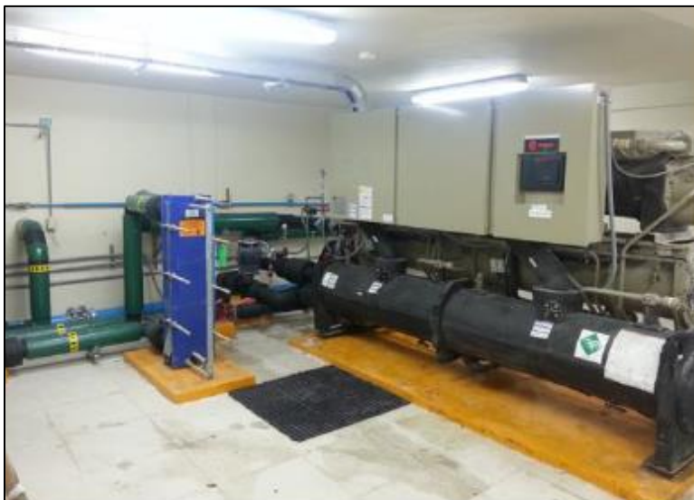
Figura II.13 Sistema de Recuperación de Calor
