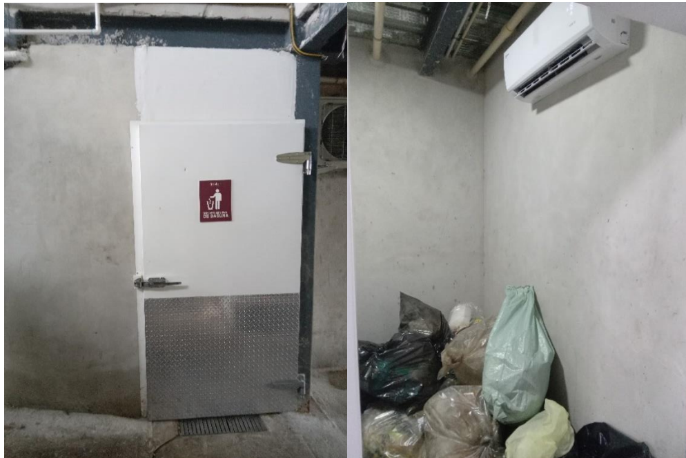
Foto 12.- Cuarto frio para almacenamiento temporal de residuos compartido con el restaurante contiguo.
