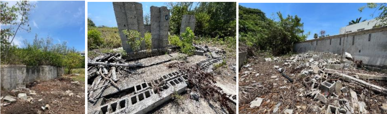
Figura IV-40. Condiciones prevalecientes sobre el predio vestigios de obras del centro de diversiones México Mágico
