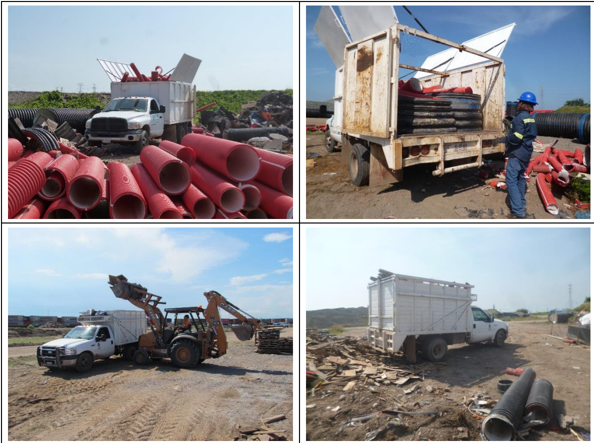
Figura II-18. Ejemplo de manejo y transporte de los diferentes tipos de residuos de manejo especial generados durante los procesos constructivos de proyectos en desarrollo.
