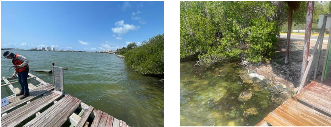
Figura 4. 90. Sitio S10, se observa el muelle viejo abandonado y muy deteriorado, presencia de manglar en las orillas de La Laguna Bojórquez.
