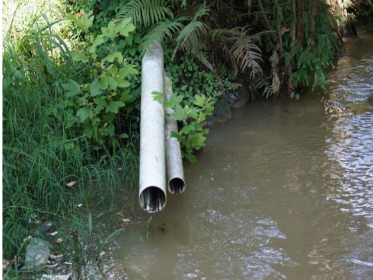
Foto IV. 27. Contaminación del río Blanco por descargas de aguas residuales.
