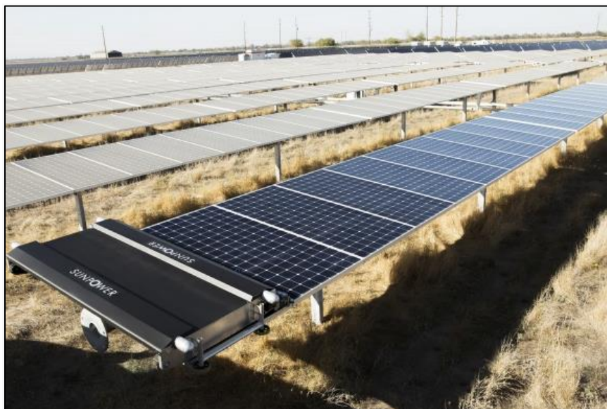
Figura II.11 Referencia del método de limpieza de los paneles fotovoltaicos 5
