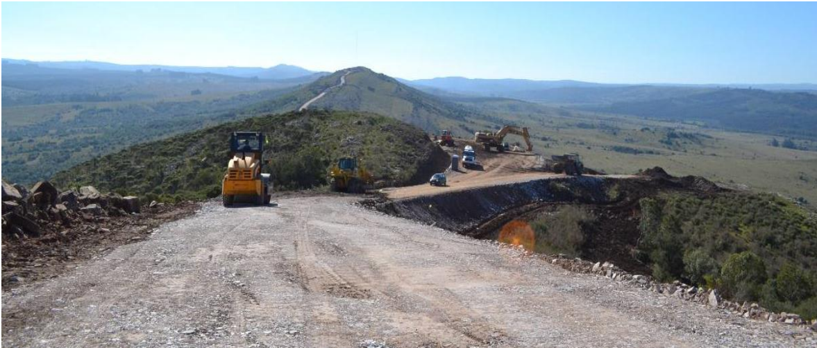
Figura 2.10. Ejemplo de la caminaria y empleo de maquinaria pesada y otros vehículos de menor envergadura.
