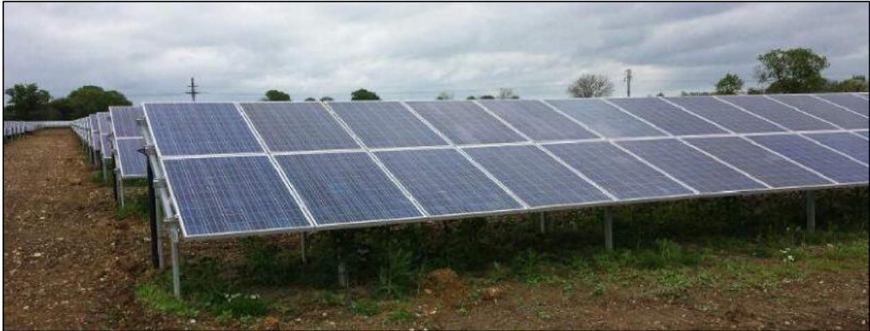
Figura II.10 Foto ilustrativa de paneles fotovoltaicos.
