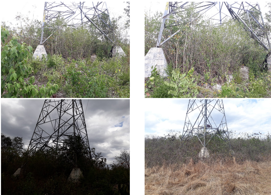
Figura 5. 4. Vista de las condiciones en las que se encuentra la línea de transmisión.
