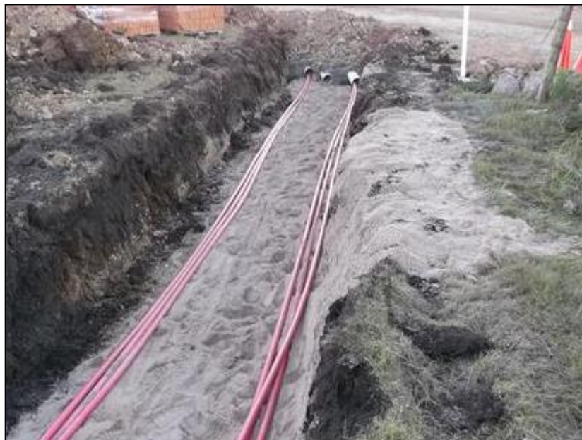
Figura II.21. Conductores de la red de media tensión.
