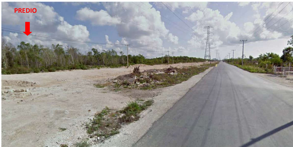
Figura 36. En el lado izquierdo se observa un Camino terrazo en proceso y en el lado derecho carril totalmente asfaltado de la Av. Huayacán.
