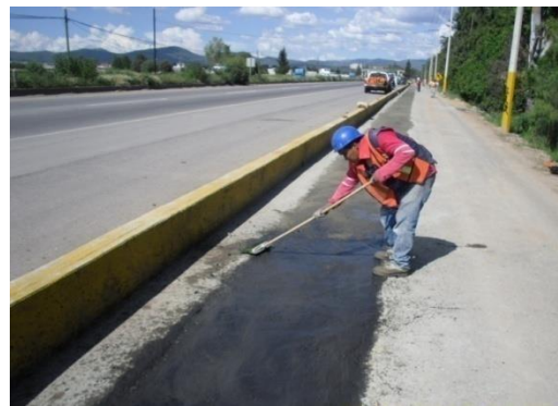
Fotografía ilustrativa de los trabajos de alisado y cuidado del fraguado del concreto sobre la zanja del gasoducto.
