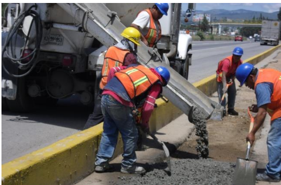
Fotografía ilustrativa de los trabajos de recubrimiento con concreto sobre la zanja del gasoducto, si en alguna parte del proyecto se requiere.
