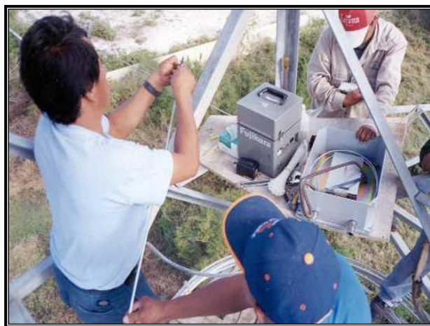
Figura II.17 Pruebas preoperativas en una estructura de línea de transmisión.
