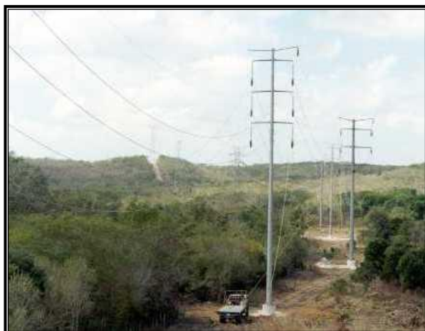
Figura II.16 Tendido y tensado de cables en una línea de transmisión con postes tronconcónicos.
