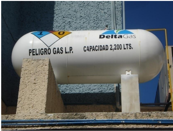
Fotografía 2.8.- Se observa el tanque estacionario existente en las instalaciones del restaurante
