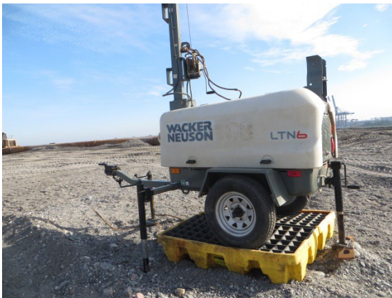
Protección de equipos contra fuga de hidrocarburos
