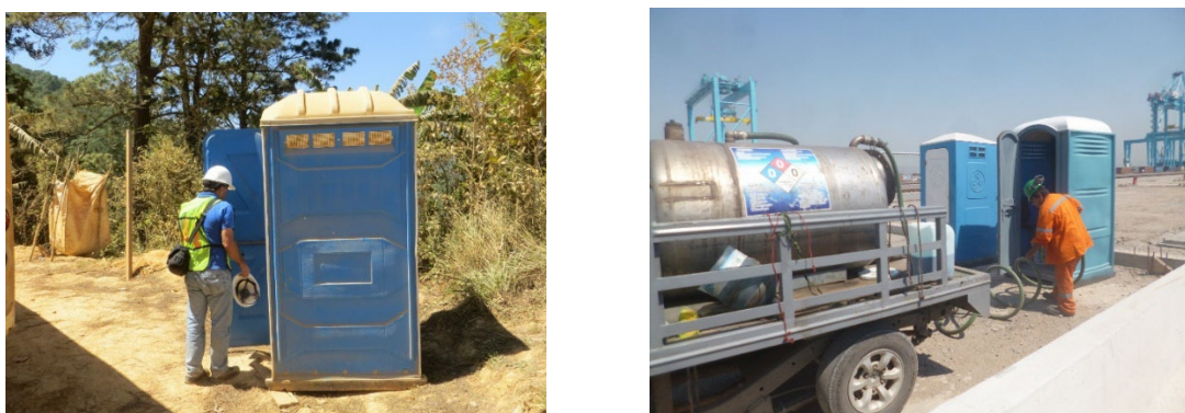
Figura II-6. Ejemplo de la habilitación y mantenimiento de baños portátiles instalados en frentes de trabajo para uso de los trabajadores.
