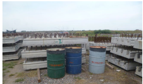
Instalación de contenedores para la colecta temporal de residuos sólidos urbanos.
